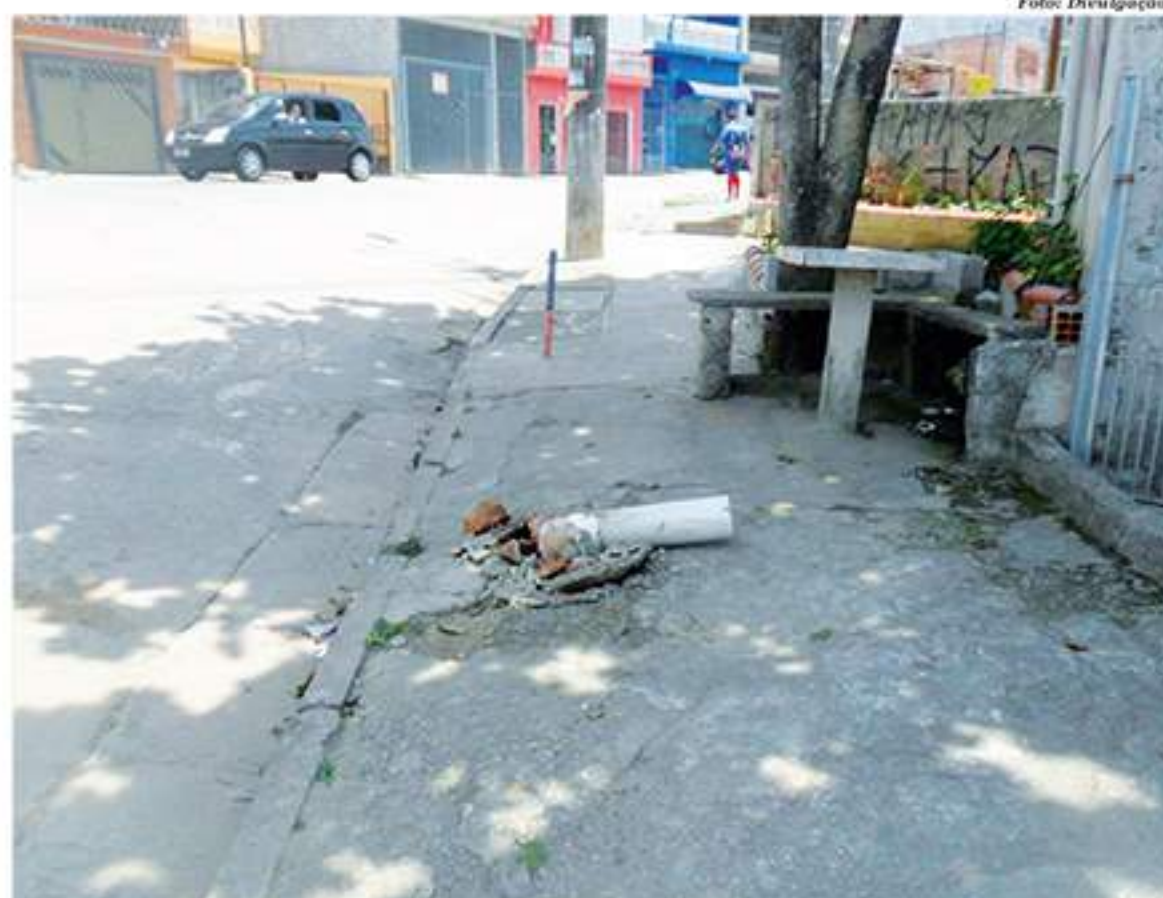
Pilastra de concreto foi derrubada por ônibus na última sexta-feira. Segundo morador, incidentes com veículos grandes são constantes no local
