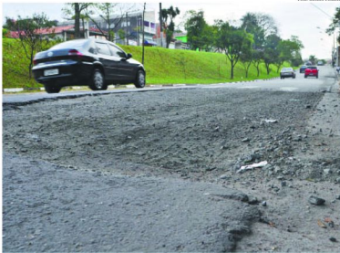
Buraco em frente a FADIM já foi consertado diversas vezes, segundo Manoel Lopes. Porém, ele sempre volta
