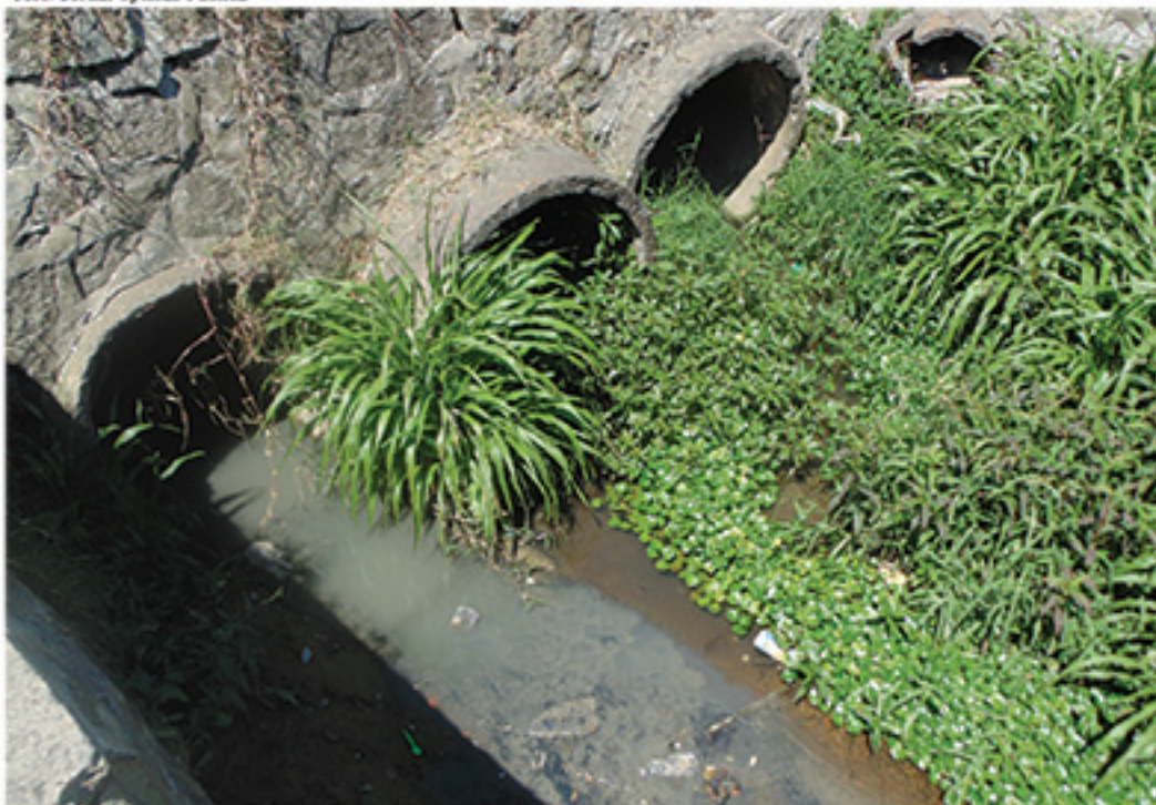
Esgoto que vem de fábrica ao lado do Parque da Gruta se mistura com água límpida que vem de nascentes a cerca de 50 metros da entrada principal
