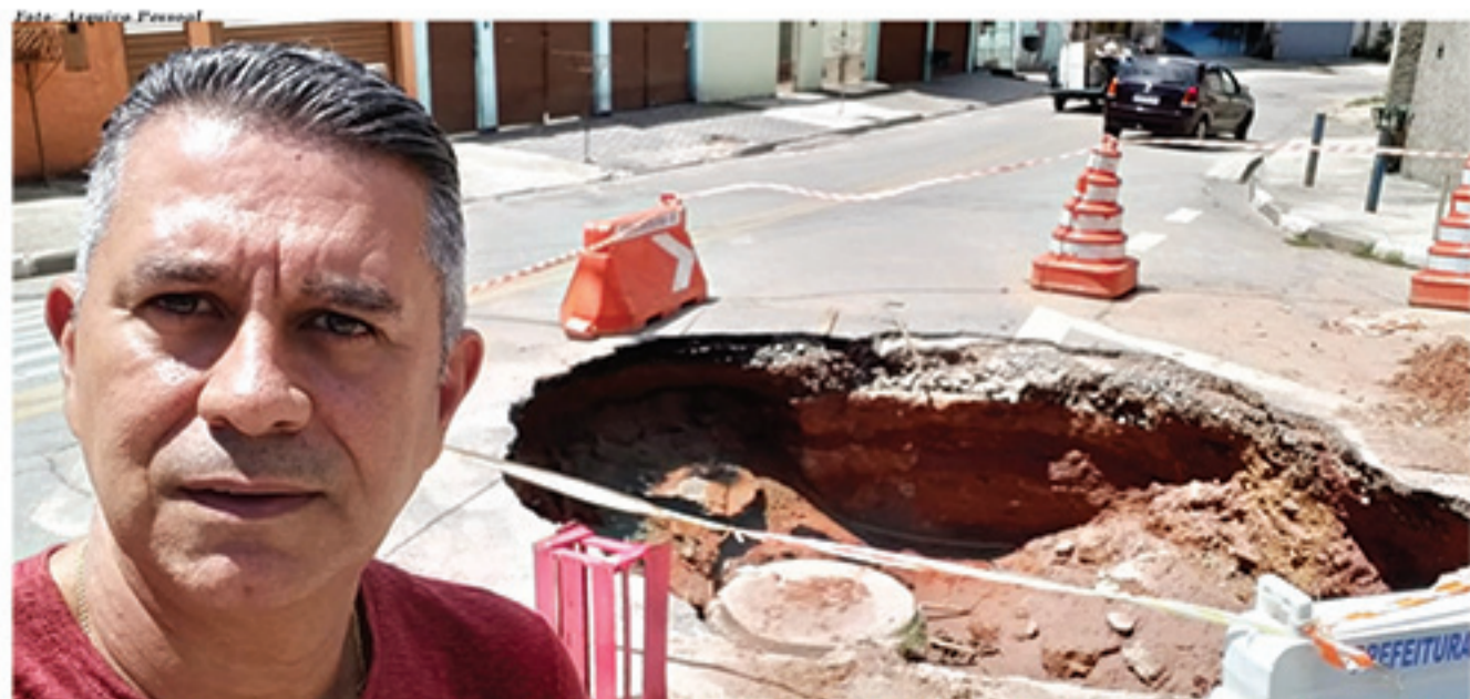
Cratera na esquina entre as ruas Eucalipto e Pau Brasil, na Vila Magini, tem dificultado a circulação de veículos e pedestres no local
