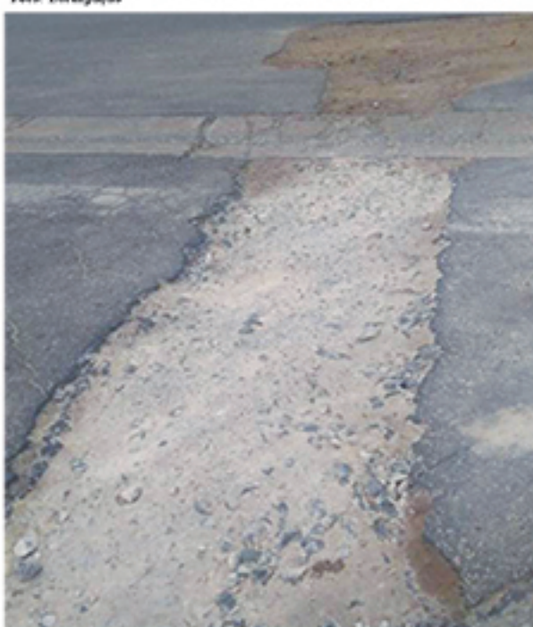
Buracos estão se espalhando pelas vias de diversos bairros de Mauá
