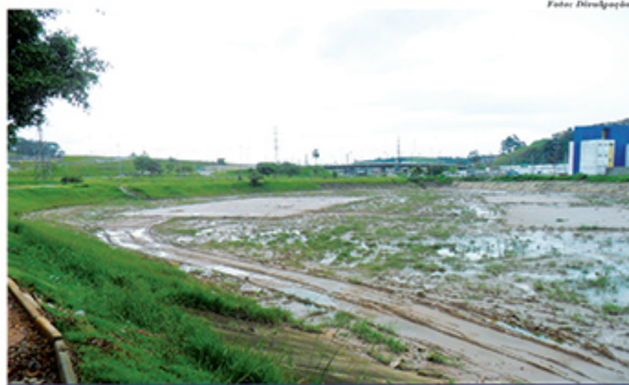
Piscinão do Paço Municipal, um dos quatro de Mauá, já não consegue escoar a água das chuvas, o que acaba causando alagamento na região quando chove com mais intensidade
