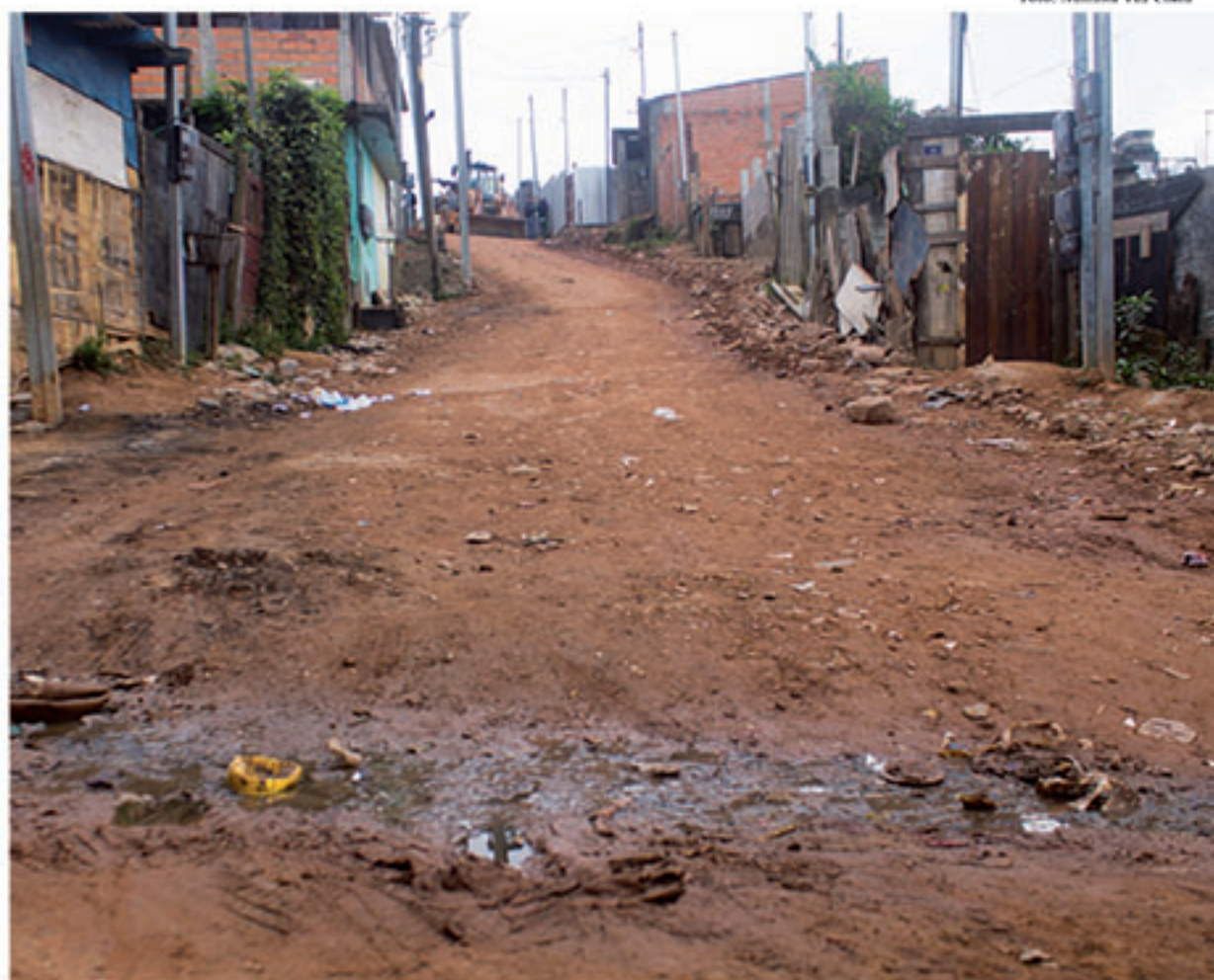
Diversas vias do Jardim Oratório ainda se encontram em uma situação como essa, sem pavimentação alguma
