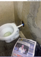
Foto tirada neste mesmo momento que infraestrutura do Hospital Nardini realmente está deteriorada, como denunciou familiar de uma paciente.
