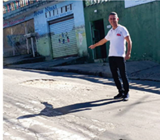
Aguinaldo de Souza tem percorrido diversas ruas de Mauá e constatado problemas como vias esburacadas, como no Jd. Itapark
